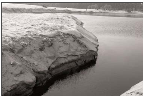
Unterspültes Ufer an einem Baggersee.
